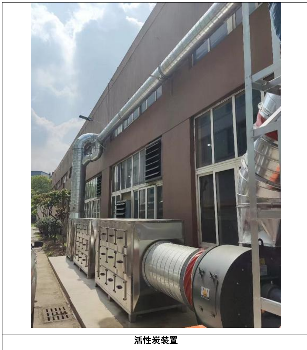
图 4-3 废气处理设施
